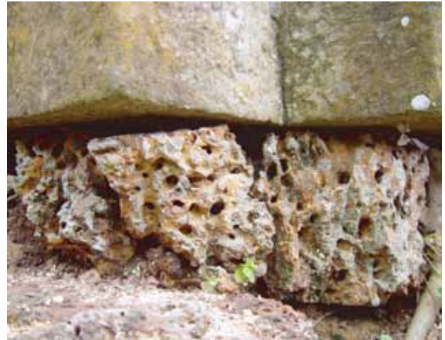
劣化したラテライト Deteriorated laterites
