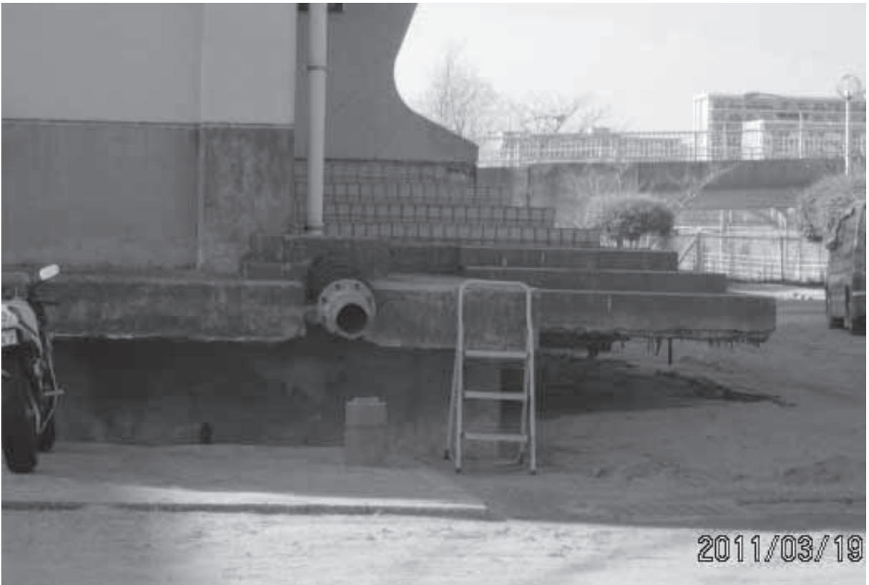
写真-7 東日本大震災浦安地区における液状化による地盤沈下
