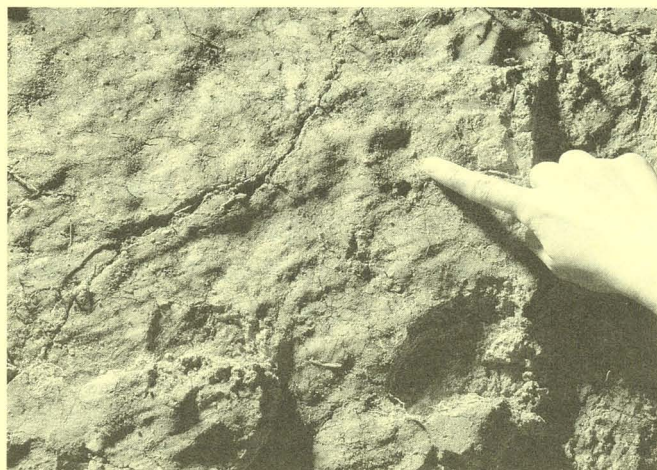
版築層に残るムシロ目と搦き棒の痕跡
