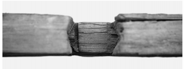
図14 壁板仕口底部に残るノコギリ痕 (南面西壁板2段目)
