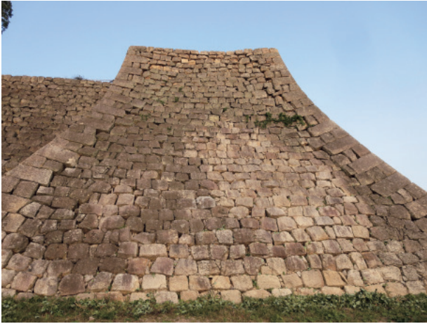
図5 石垣毀損状況
