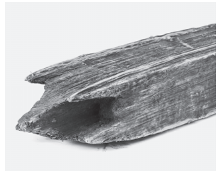
図243 部材上端の腐朽と仕口の痕跡
