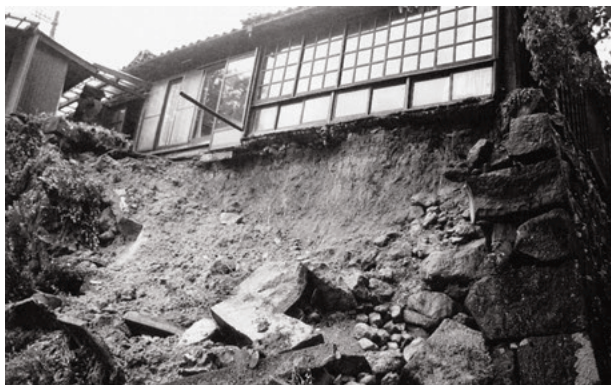
図4 二之丸の石垣上の茶店と石垣の崩落（平成5年）
