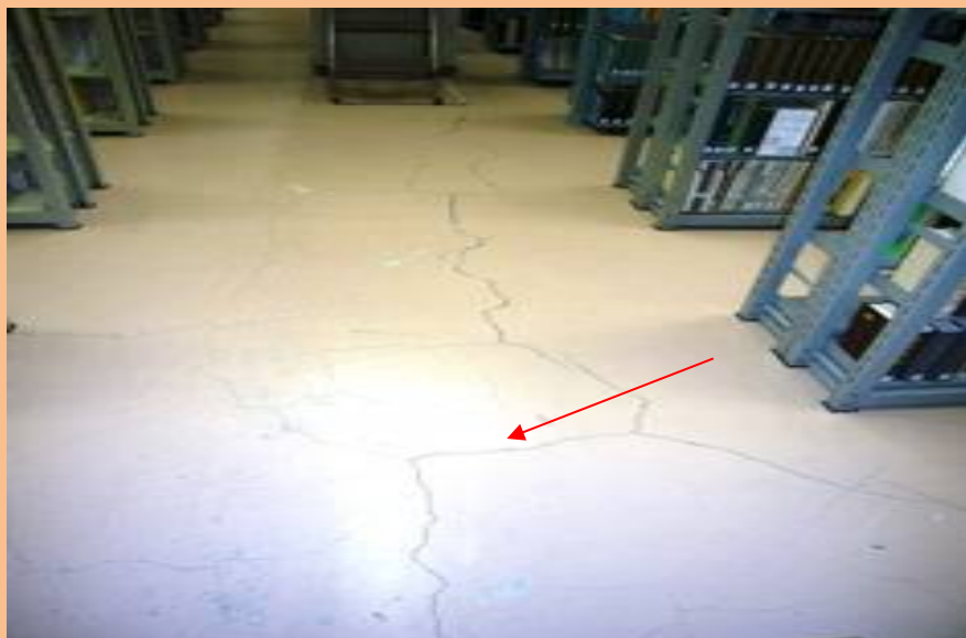
①建物内部 床クラック
