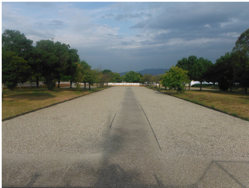
仮設庁舎設置現場 (H25. 8. 29 佐伯門方向より撮影) 工事用フェンス設置後
