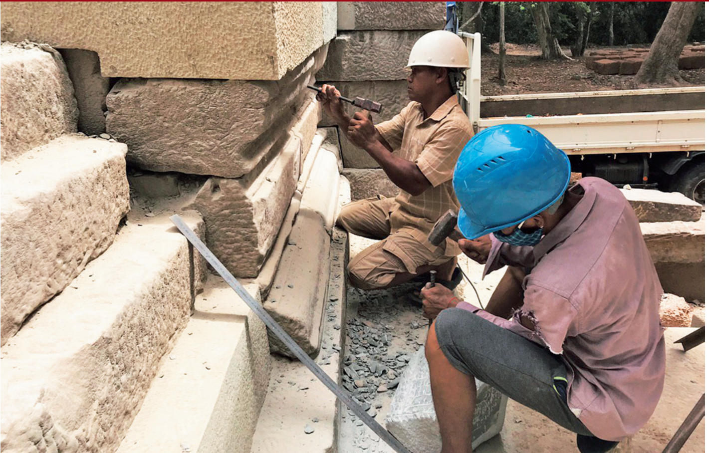
国際遺跡研究室：カンボジア・アンコール遺跡群西トップ遺跡修復事業作業風景 International Cooperation Section: Restoration work at Western Prasat Top, Angkor site group, Cambodia
